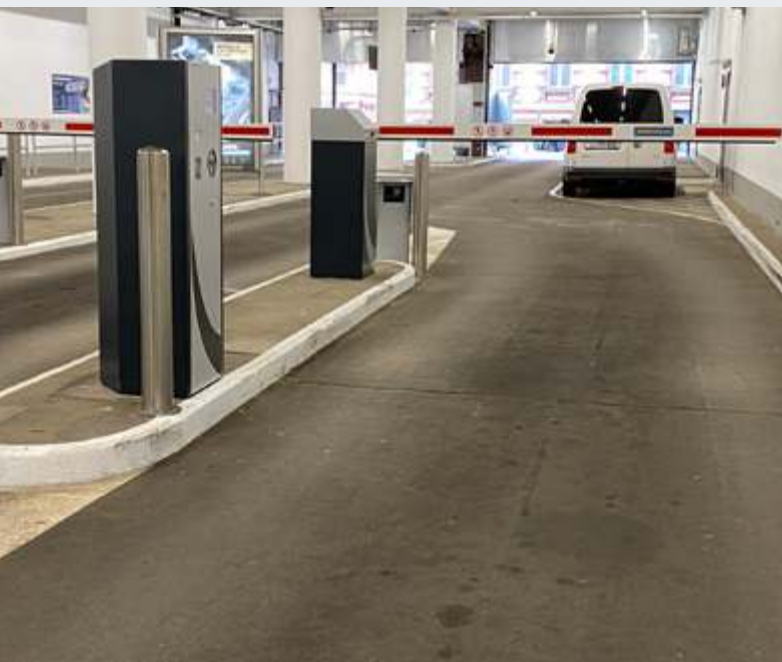
Anlagenschutz innen, z. B. Kassenautomaten, Schranken
