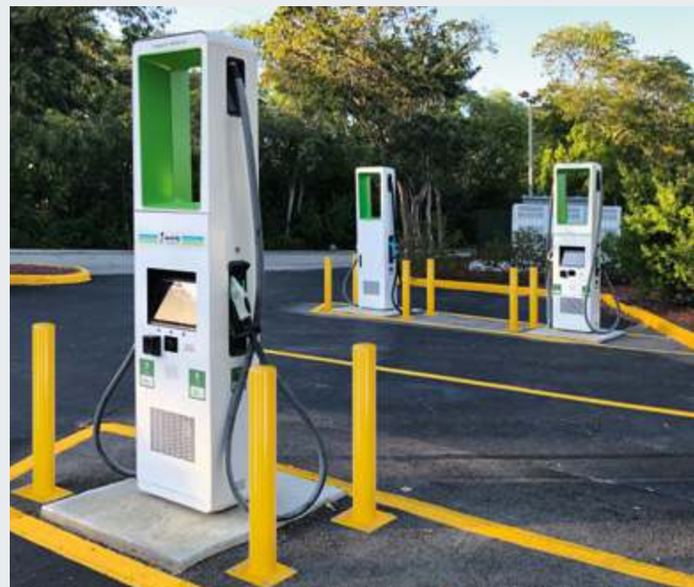
Anlagenschutz außen, z. B. für E-Ladesäulen
